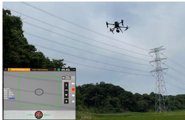
Fig. 2. 小型 UV カメラのドローン搭載実証試験例 (破線の丸の中の点がコロナ放電箇所)
